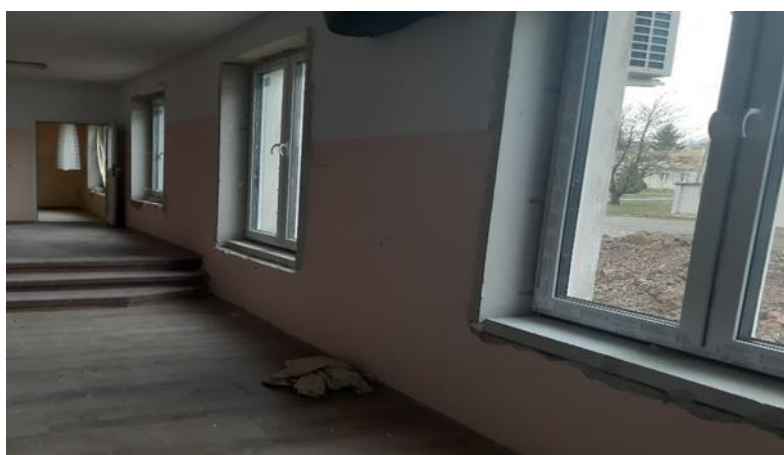
Źródło: Urząd Gminy w Płońscy, Termomodernizacja budynku gminnego w miejscowości Gródku na działce nr 79/15
