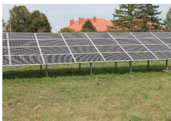
Fot. instalacja fotowoltaiczna SUW Płośnica
